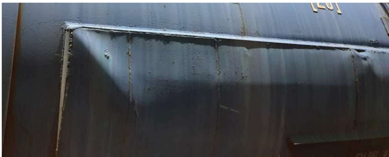
Рисунок 2 – Вмятина обечайки котла в зоне паровой рубашки (вид вмятины снаружи, паровая рубашка демонтирована)
